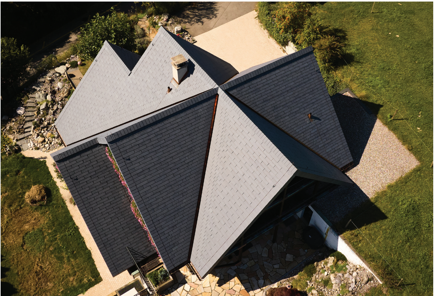
Abb. 2: Die Vogelperspektive zeigt die zehenseitige Dachform des Hauses. Um dieser aussergewöhnlichen Form gerecht zu werden, wurden massgeschneiderte PV-Module installiert.
