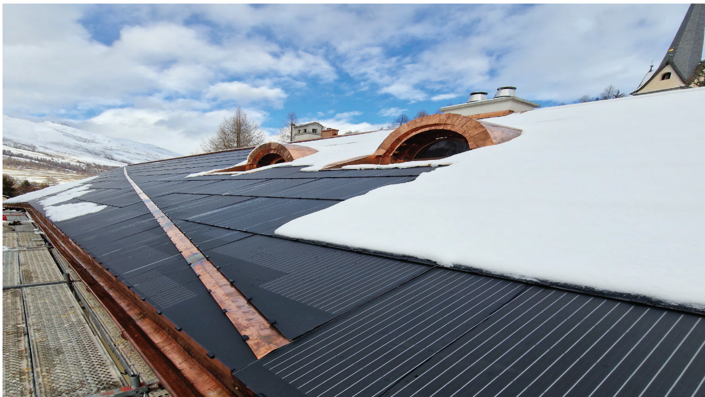
Abb. 2: Das sanierte Dach des Engadinerhauses, ausgestattet mit hocheffizienten Photovoltaik-Modulen, weist eine Leistung von 54,3 kWp auf und produziert jährlich 36'400 kWh Solarstrom. Damit wird der durchschnittliche Jahresverbrauch von 16'300 kWh übertroffen.
