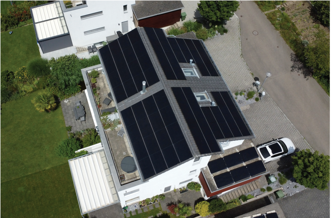
Abb. 1: Die Installation leistungsstarker PV-Dachmodule verwandelte das 2006 erbaute Minergie-Doppelhaus in einen PlusEnergiebau. Die in der unteren Bildhälfte sichtbare Haushälfte erreicht mit einer Gesamtleistung von 15.6 kWp eine CO 2 -freie Eigenenergieversorgung von 306%.
