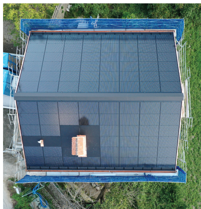
Abb. 3: Die Vogelperspektive verdeutlicht die perfekte Integration der PV-Module in die ganze Dachfläche.
