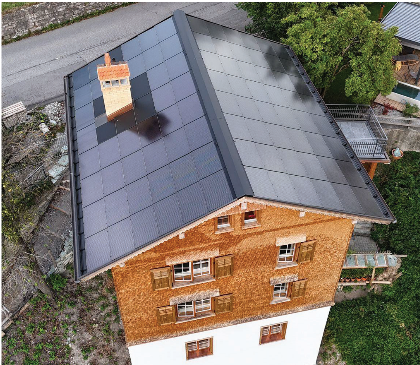
Abb. 1: Die neu installierte PV-Dachanlage mit einer Leistung von 17,55 kWp produziert jährlich rund 16'700 kWh CO 2 -freien Solarstrom.
