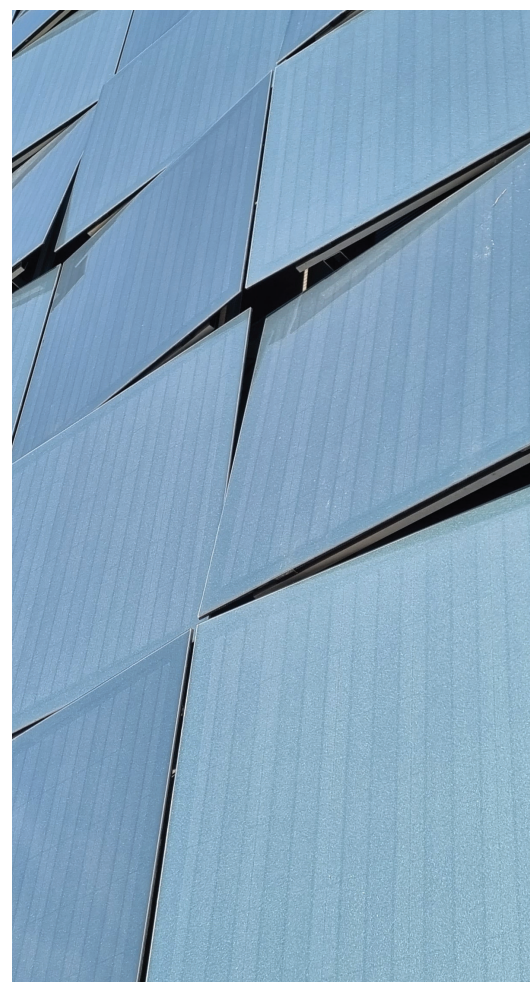
Abb. 3: Durch die kreative Anordnung der Module entstand eine Fassade mit einem einzigartigen, an eine „Laterne“ erinnernden Aussehen.
