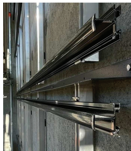
Abb. 1: Die Brandschutzvorrichtung entspricht dem neuesten Stand der Technik.
